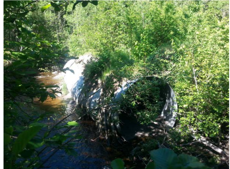
Fig. 6. Le vestige d'un ponceau observé à la station de pêche électrique.
