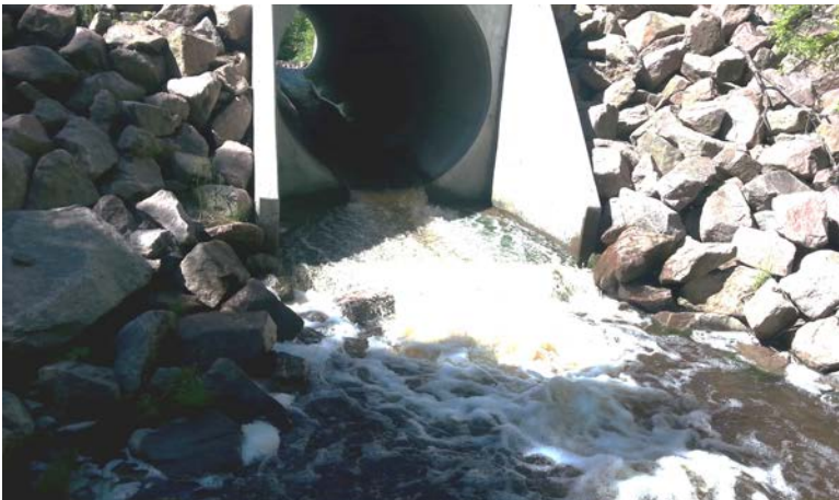
Fig. 21. Deux cascades de 15 et 45 centimètres sont présentes en aval du ponceau créant un obstacle infranchissable pour le poisson.
